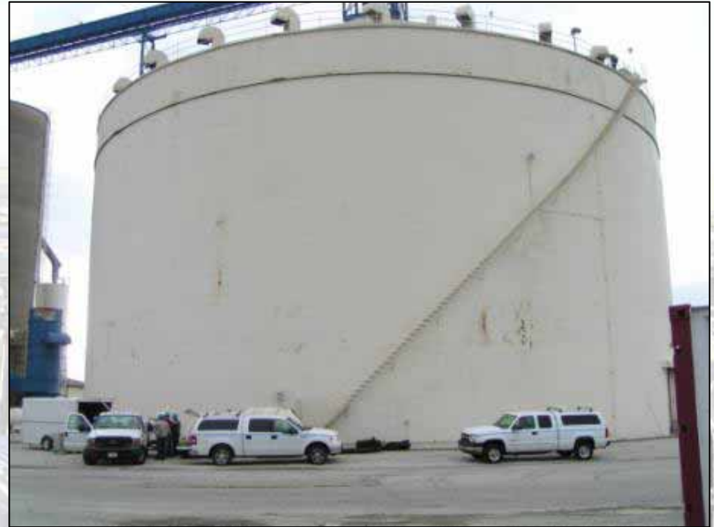
Silos de 60.000 toneladas sin sistema de ventilación. Evansville, USA
