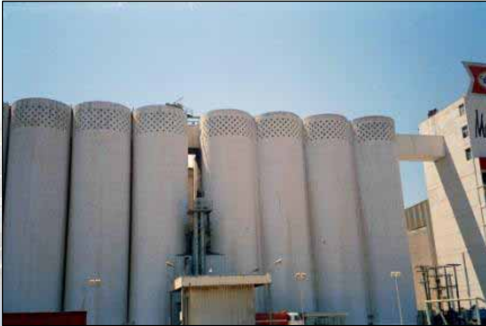
Silos de 800 toneladas sin sistema de ventilación. San Bernardo, Chile
